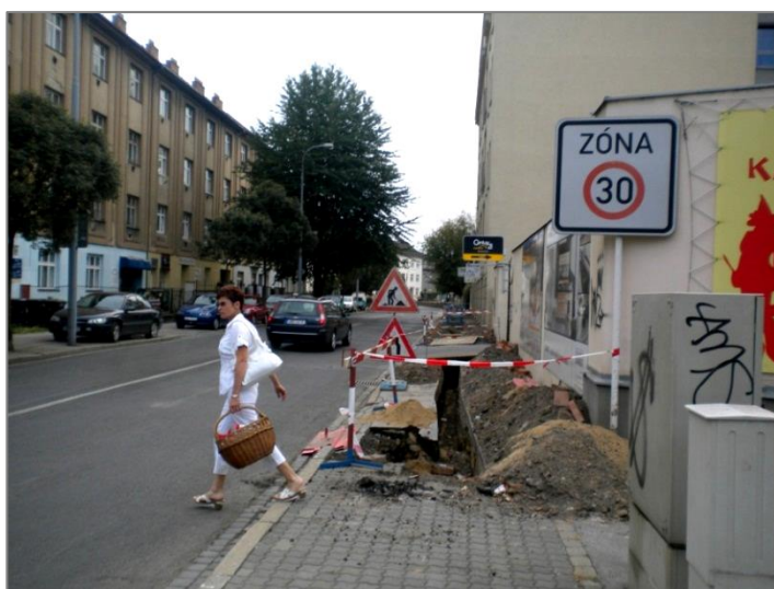
— Obrázek 69: Nebezpečné a chybné označení výkopu – vždy je nutné ohrazení pevnou zábranou s dolní zarážkou (Brno).
